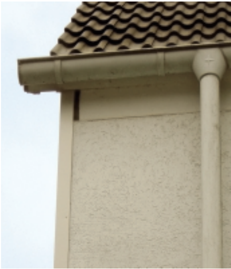
Abb. 2: Potenzielle Einfluglöcher, die im Zuge einer Wärmedämmung verloren gehen. Foto: F. Cassese
